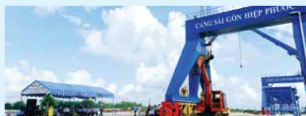
Dự án: Cảng Hiệp Phước- huyện Nhà Bè- TP Hồ Chí Minh Project: Hiep Phuoc Port in Nha Be district, Ho Chi Minh City
